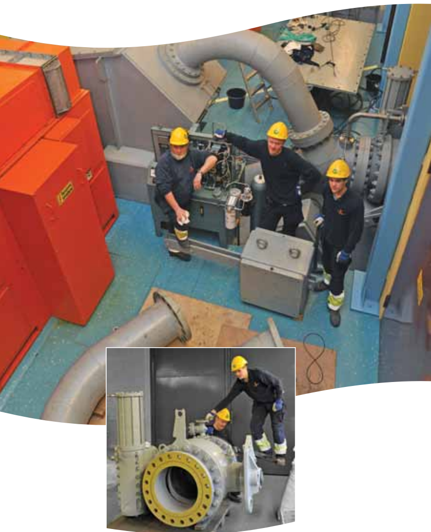
Revisjon av aggregat i Moksa kraftverk. Stort bilde, fra venstre: Maskinmester Gunnar Larsen, elektromaskinist Hans Sveipe og lærling Anders Stensrud. Lite bilde: Hans Sveipe og Anders Stensrud.
