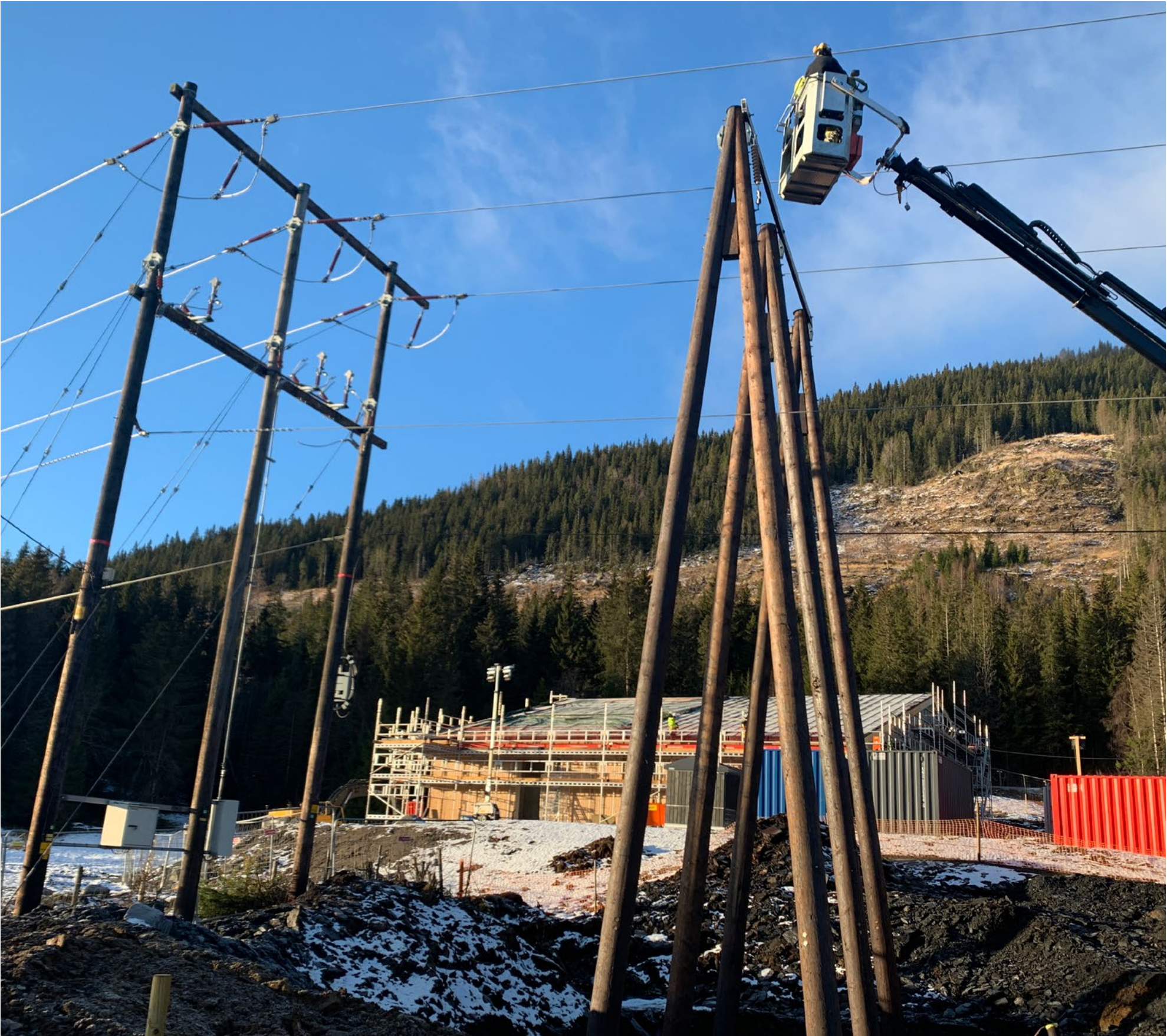
Høyspentlinja bygges om for å forsyne Fåvang trafostasjon (i bakgrunnen). Foto: Arne-Ivar Myrvang
