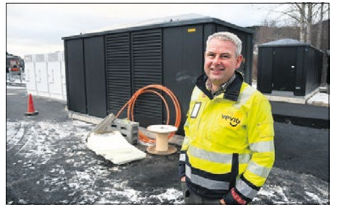
LEVERER BILSTRØM: Vevig har satt opp tre nye trafoer ved ladeanlegget. - Kostnaden dekkes av utbygger, sier daglig leder Johannes Bergum.
