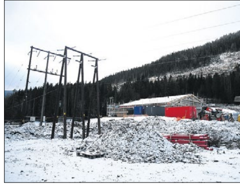
NYBYGG: Trafostasjonen er strategisk plassert langs strømnettets E6 - 66 kV-linja som transporterer energi fra de store kraftverkene i Gudbrandsdalen.
