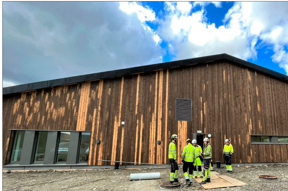
Noe av panelen som er behandlet med jernvitrol, har ikke tatt farge. Dette skal rettes opp i løpet av sommeren, opplyses det. ALLE FOTO: BEATE HOVDE
