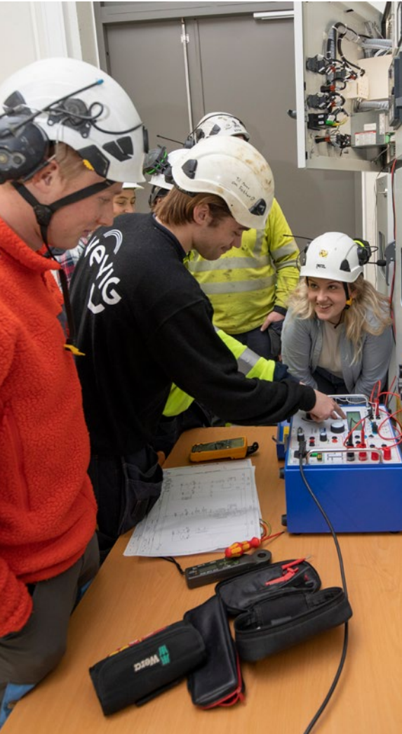
Lærlinger tester vern i Fåvang trafostasjon. Foto: Nils Ormvold
