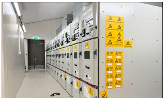
Ved strømbrydder har de god oversikt på dette styrepanelet.
