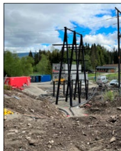
Ny kabelmast fordeler strømmen mellom Ringebu og Tretten.
