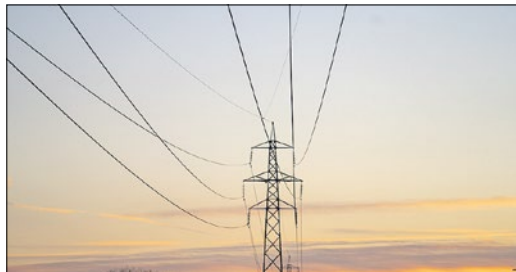
SPRENGT: Et økende strømforbruk gjør at kapasiteten i strømmettet er sprengt flere plasser i Gudbrandsdalen.
