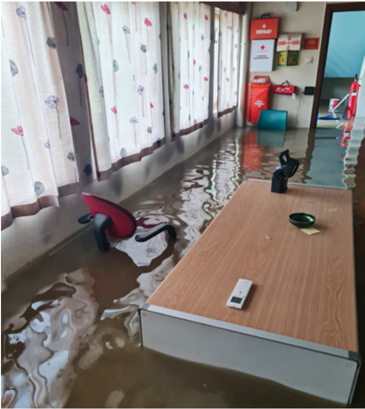
Fra ekstremværet «Hans» i august 2023. Ringebru trafostasjon ble oversvømt. Foto: Hans Sveipe
