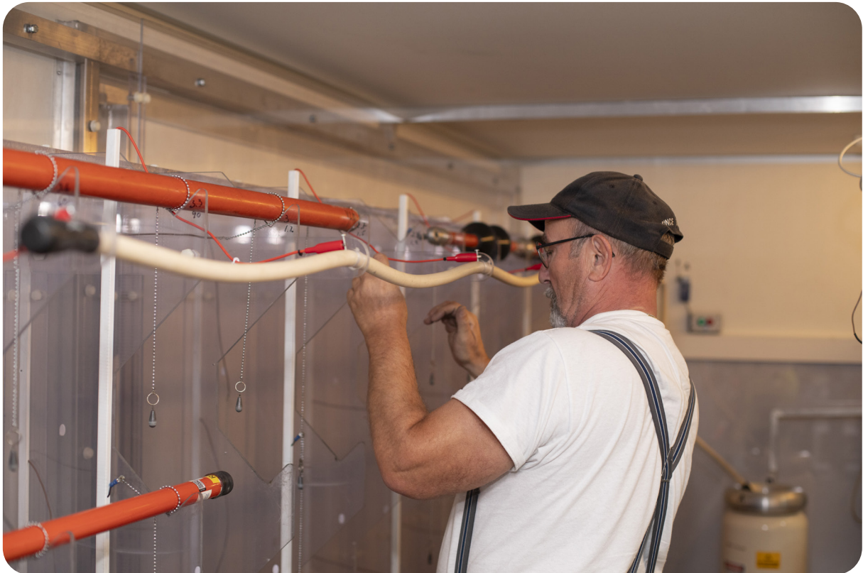
Ragnar Skogdalen fra Live Work Consult utfører sakkyndig kontroll av AUS-utstyr (utstyr som brukes ved arbeid på spenningssatte anlegg). Foto: Nils Ormvold
