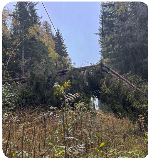
Trefall på høyspentlinje under uværet Amy i oktober.
