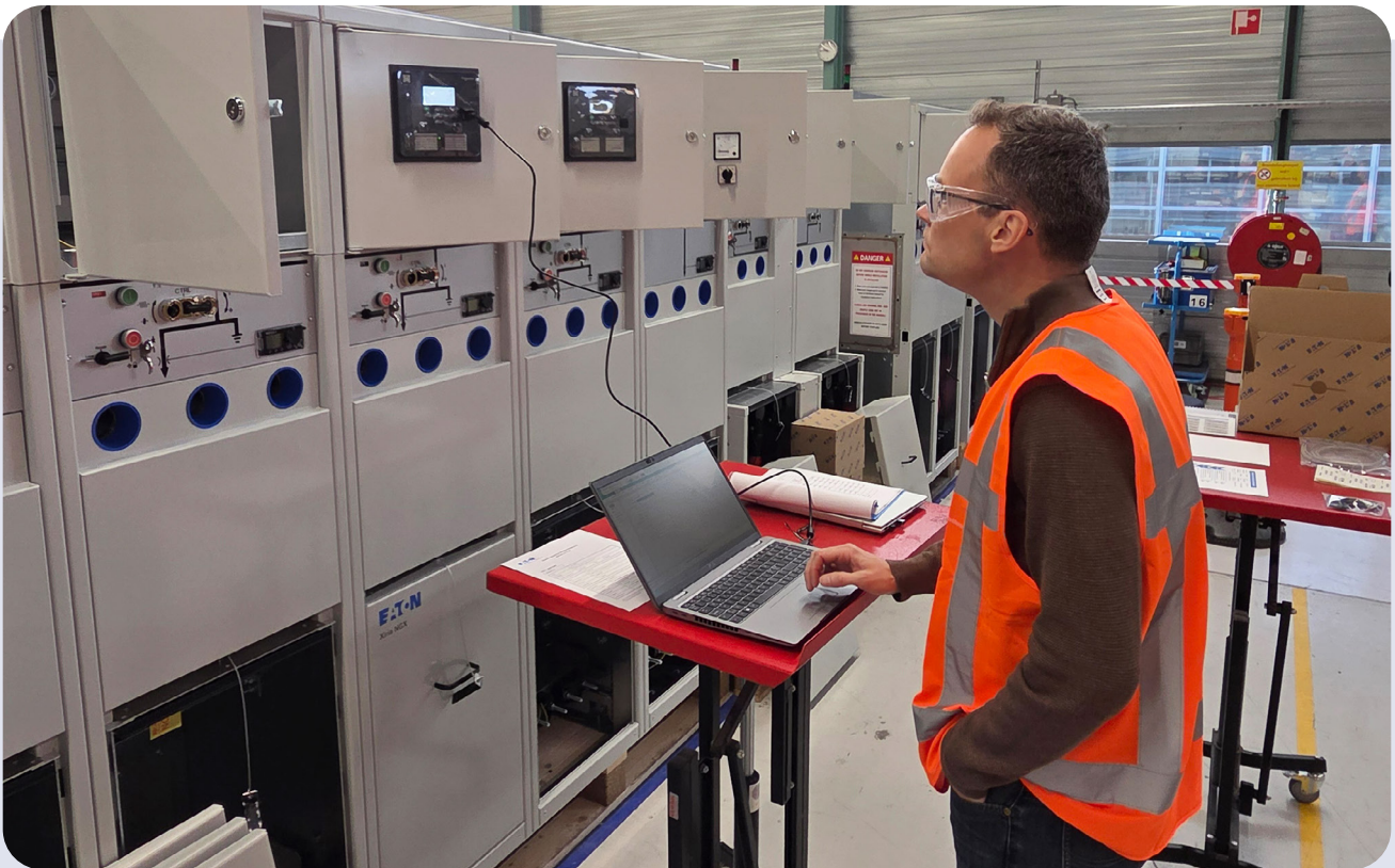
Svein Roger Aanstad kontrollerer nytt høyspent bryteranlegg hos produsenten. Foto: Hans Sveipe
