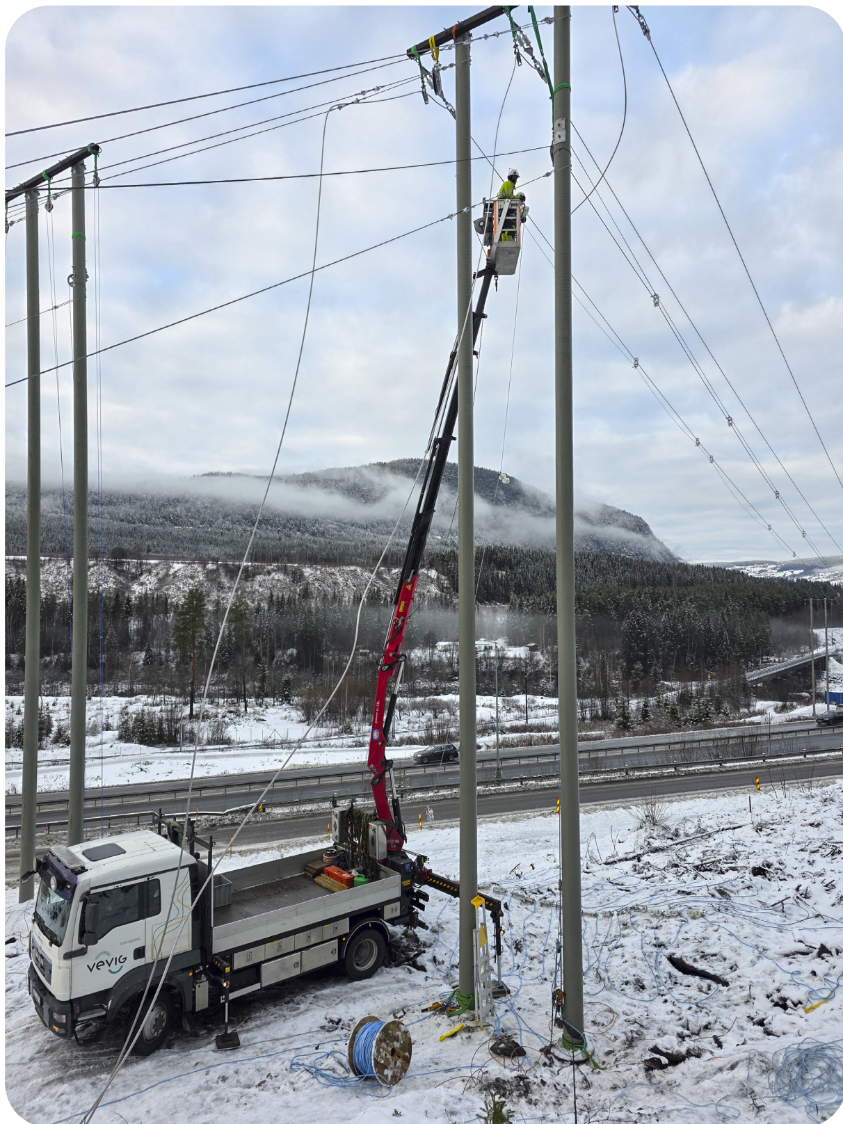
Bygging av ny høyspentlinje ved Hunderfossen, som vil gi økt kapasitet mot Hafjell-området. Foto: Henrik Endre Steinslien
