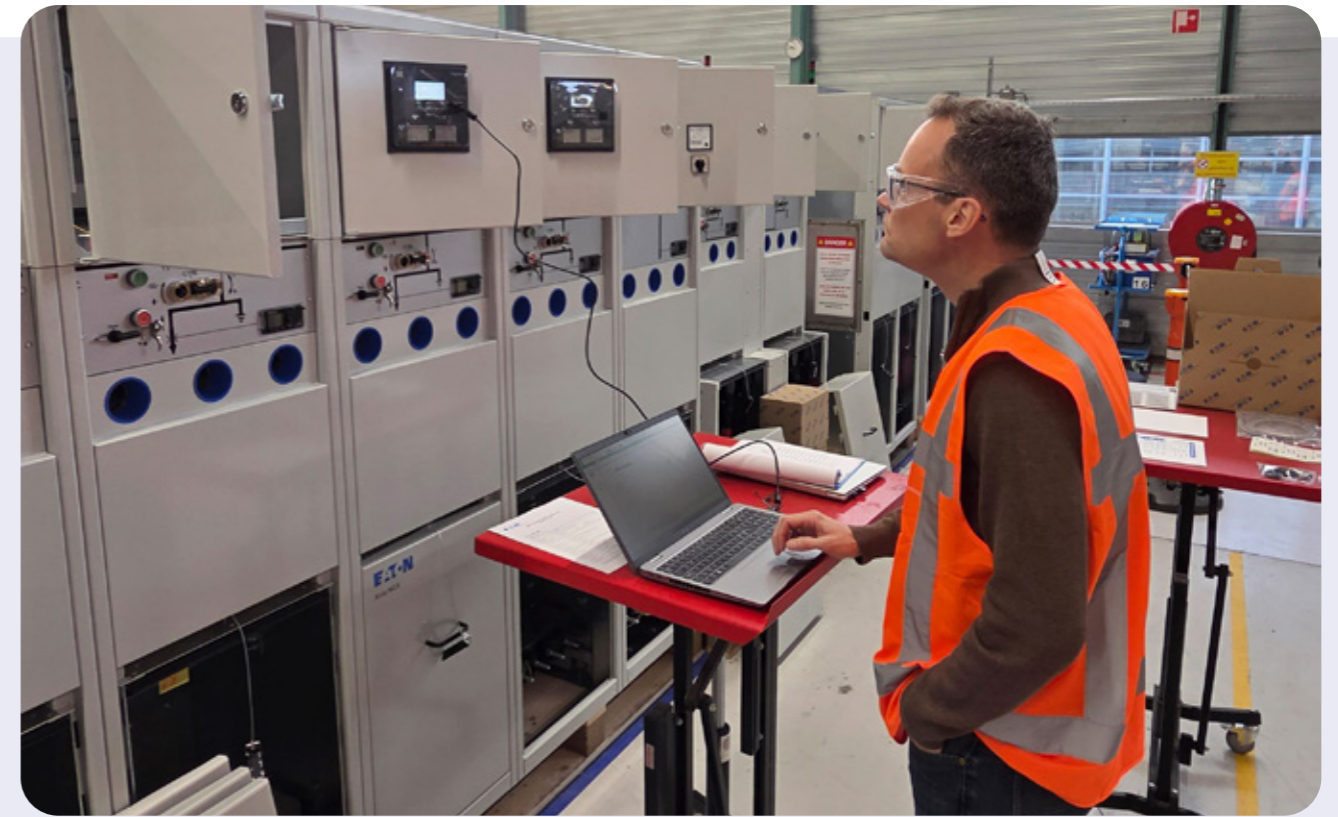
Svein Roger Aanstad kontrollerer nytt høyspent bryteranlegg hos produsenten. Foto: Hans Sveipe
